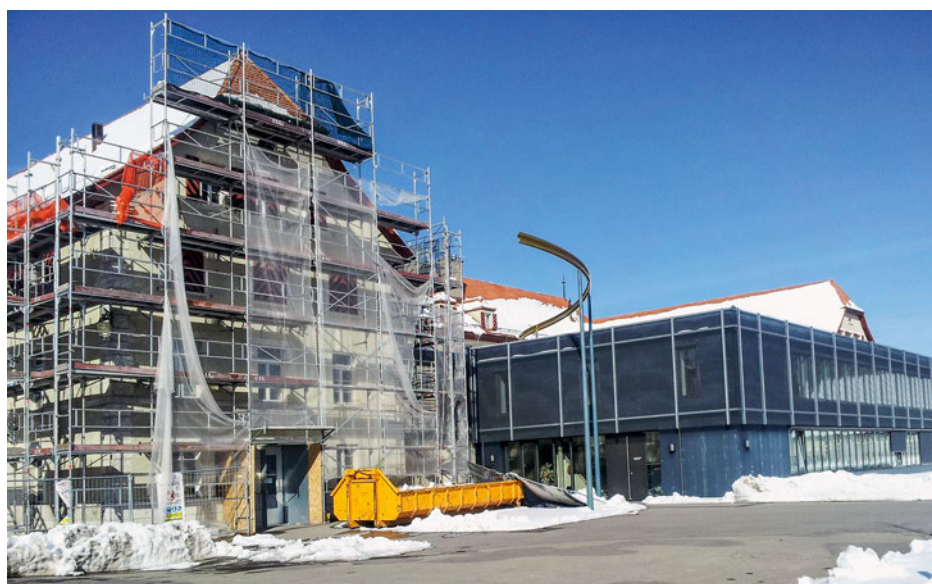
Eventuell brauchen die Folgenutzungen der Infrastruktur bauliche Massnahmen. Foto: Wyrsch
